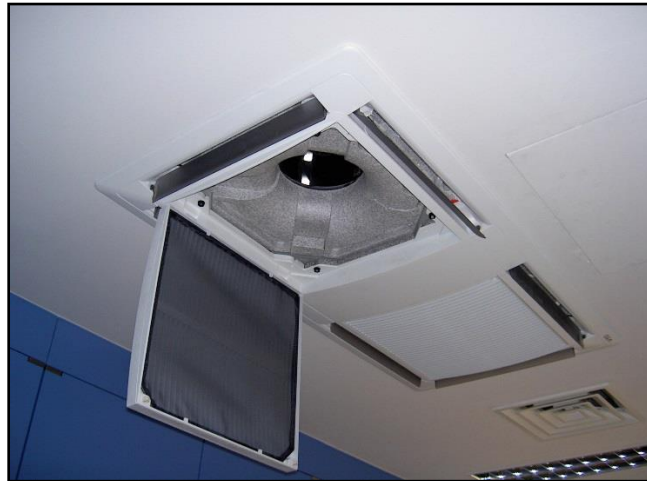
Typisches Umluftkühlgerät, in die Decke eingebaut.
