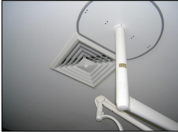
Üblicher Drallauslass für Zuluft, hier im OP-Saal.
