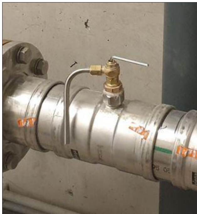
Probenahmeventil an einer Installation in der Technikzentrale
